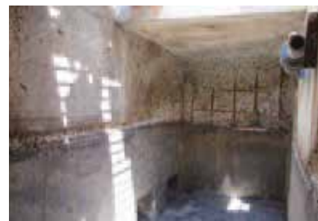
Fig. 3: Corrosión biogénica del hormigón sobre la superficie de las aguas residuales
