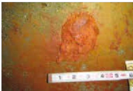
Fig. 2: Detalle del nódulo de corrosión que se forma en la superficie de un muro de hormigón.
