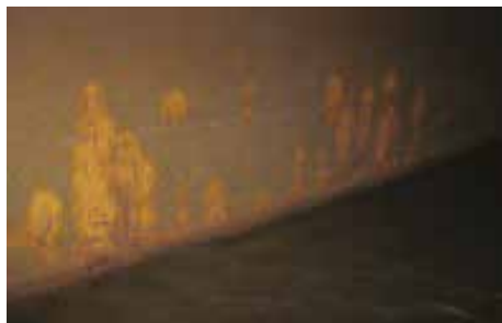
Fig. 1: Evidencia de corrosión del acero de refuerzo en la pared inferior de un canal de concreto
