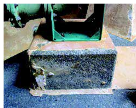
Fig. 5: Ejemplo de árido fino expuesto en hormigón sumergido expuesto a grasas, aceites y grasas (FOG).
