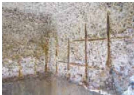
Fig. 4: El deterioro del hormigón ha expuesto y corroído completamente el acero de refuerzo.
