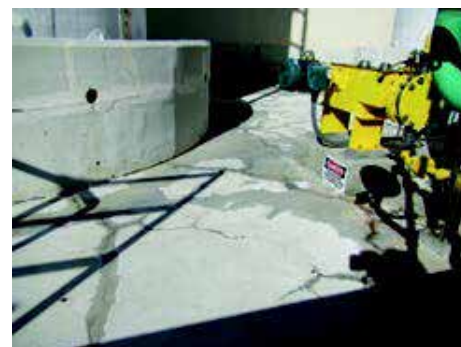
Fig. 6: Grietas severas en el piso de una estructura de contención secundaria
