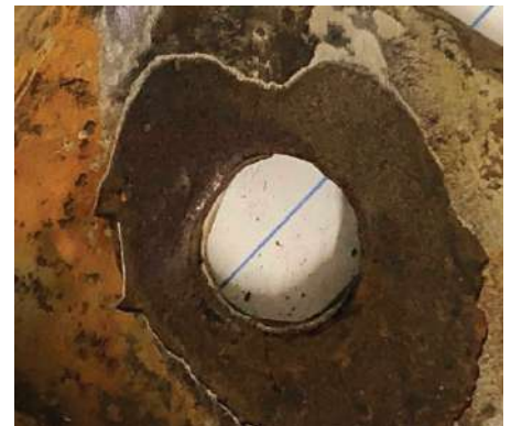
Fig. 11: Estado corroído debido al apriete excesivo de las conexiones
