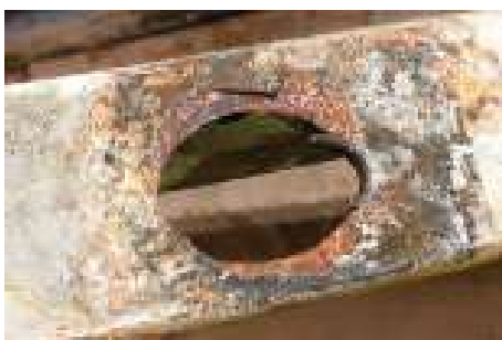
Fig. 3: Corrosión galvánica en el mecanismo del brazo de rastrillo
