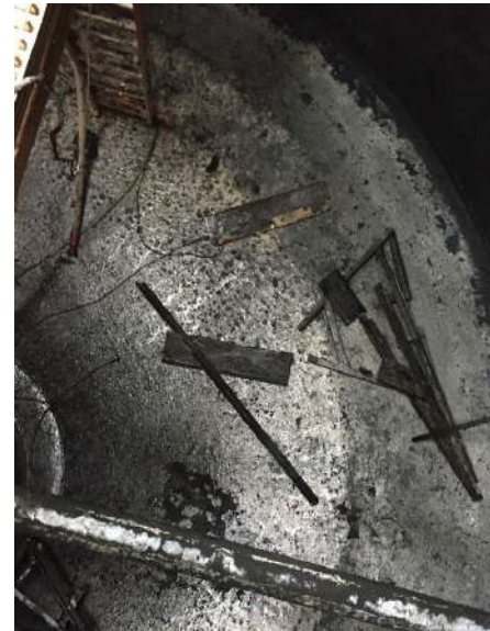
Fig. 2: Daños en el fondo del clarificador.
