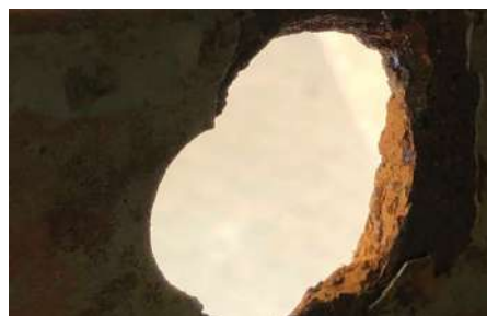
Fig. 4: Corrosión galvánica en la conexión emperrada
